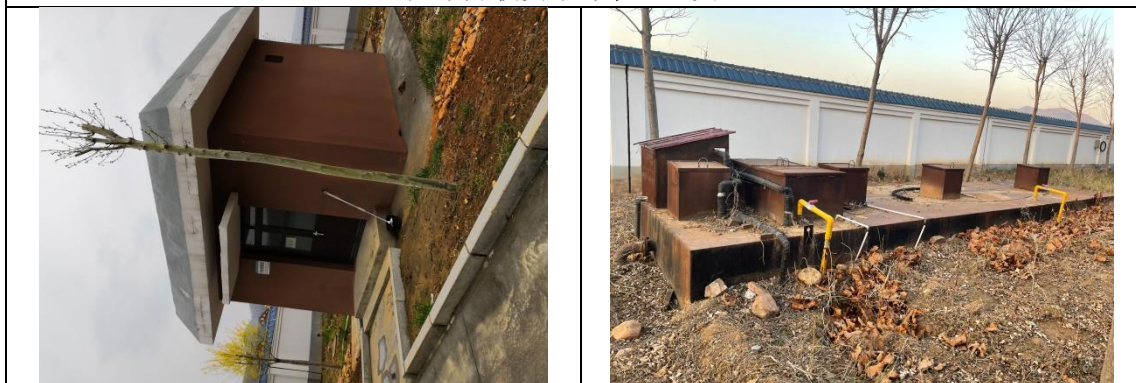
渡口收费站污水处理设施
