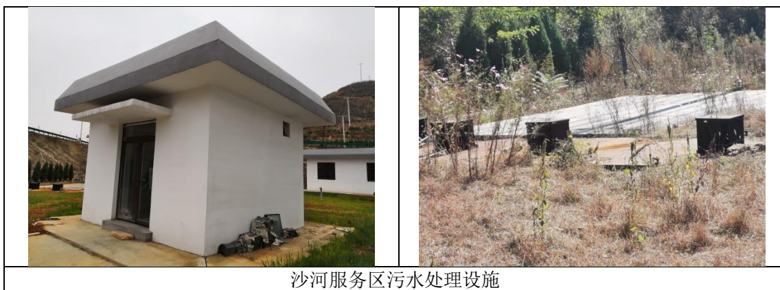
沙河服务区污水处理设施
